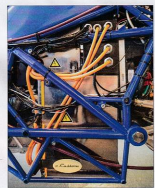
Lådorna i rostfritt stål innehåller batterier.
